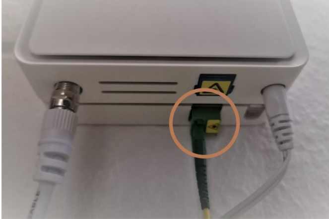
Abb. 8: Eingang für das Glasfaser am Fibertwist
